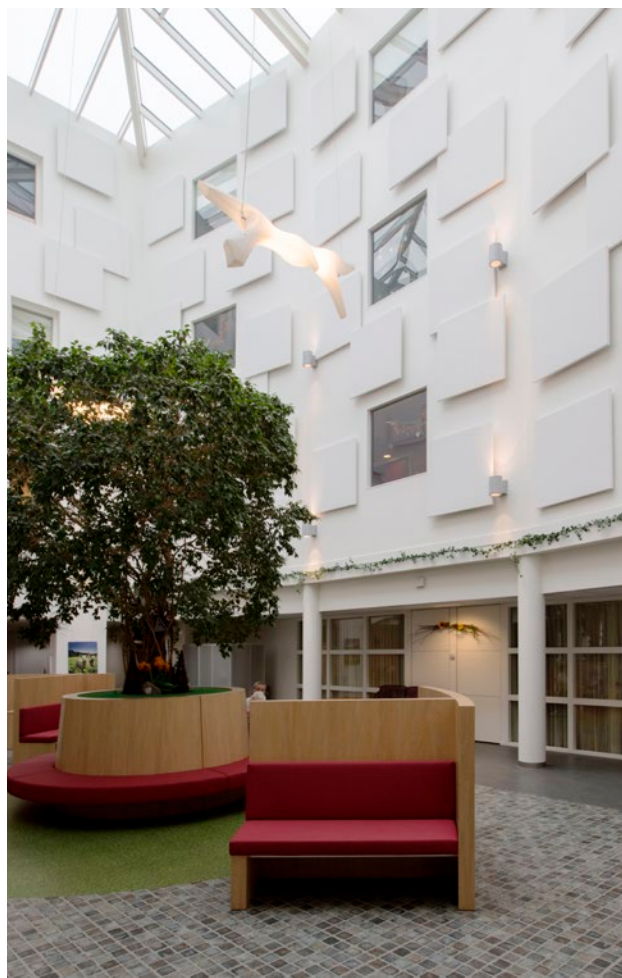
Installatør Fleurbaaij Totaal Afbouw Produkt Rockfon Eclipse®
